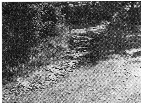
4. Odvozní cesta bez příkopu je často narušována vodní erozí. — Road for wood transport without ditch is often affected by water erosion
