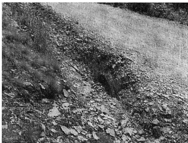
3. Příkop naplněný plaveninami přestává plnit svou funkci. — A ditch full of alluvium deposits does not fulfil its function any more
