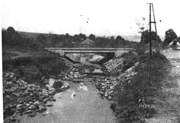
6. Kamenná úprava rozrušená pri prietoku veľkej vody. — A stone construction injured by high water discharge
