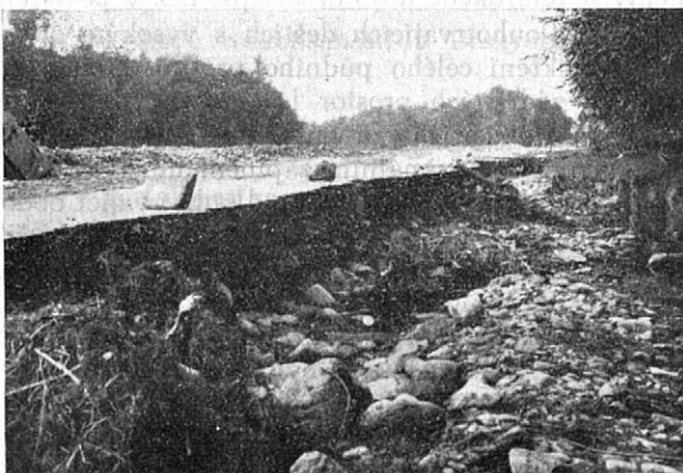
7. Následek rozvodnění Čeladenky z 26. 7. 1960 na státní silnici Frýdek Místek—Frenštát pod Radhoštěm v úseku Čeladná—Pstruží. Vody povodňové vlny opustily koryto bystřiny a strhly část silničního tělesa. Snímky Zelený.
