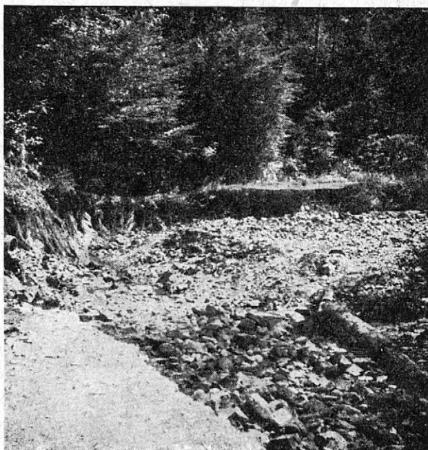
Obr. 5. Odplavení silničního tělesa v km 1,420.
