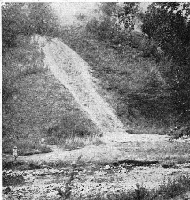
Obr. 3. Vznikající strž na levé straně v km 0,800
